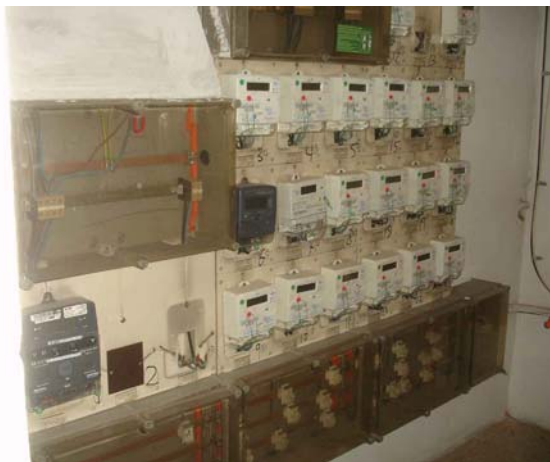
CENTRALIZACIÓN CONTADORES DE ELECTRICIDAD
